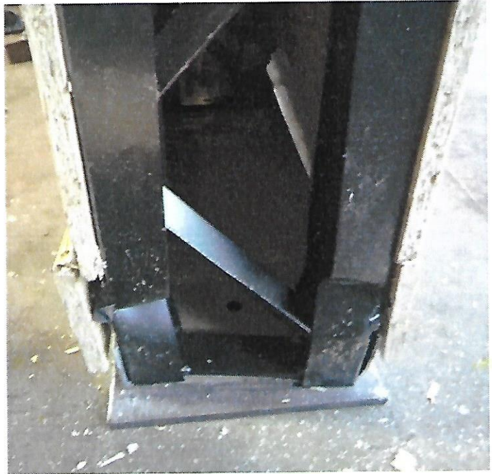
13. ábra: Lokális tönkremenetel
